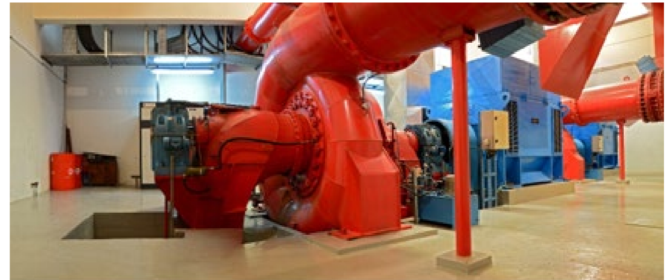
Figure 11 : Illustration de turbines de centrale hydroélectrique
